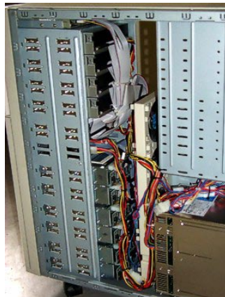
gute Kabelführung von Strom- und Datenkabeln
